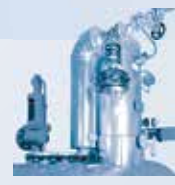
z.B. Speisewasserbehälter mit Entgaserdom
